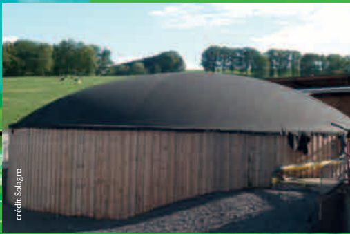
Digesteur béton couvert d'un bardage bois au GAEC Forget dans les Ardennes
