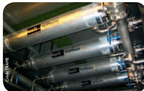
Epurateur membranaire de biogaz
