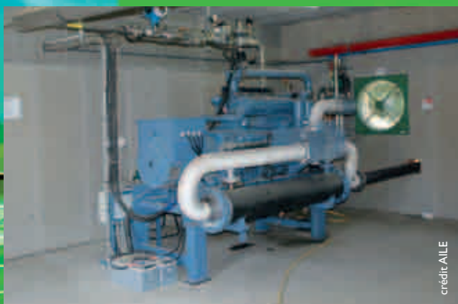
Cogénérateur biogaz de 130 kW e à l'EARL Guernequay dans le Morbihan
