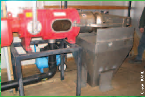
Séparateur de phase
