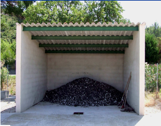
Ex de local de stockage de boues sèches, Station d'épuration de St-Jean-de-Barrou (11)
